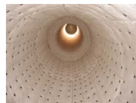
Revêtement intérieur en fibre céramique
