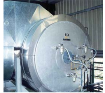
Chambre d'oxydation thermique
