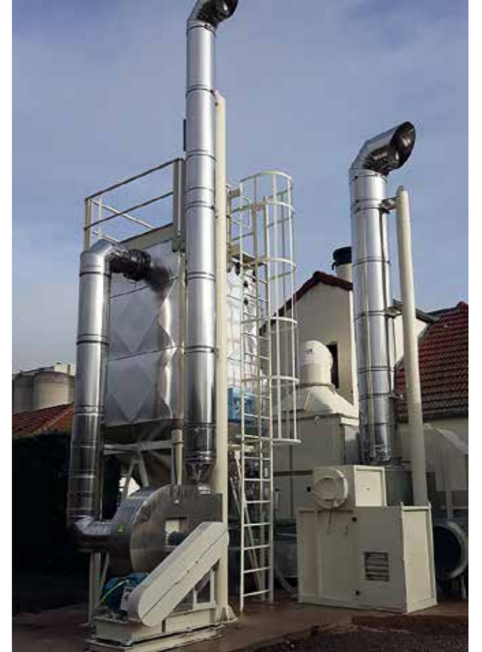
Instalación de depuración de gases en el norte de Francia. Kalfrisa demuestra su probada experiencia para acometer los cambios normativos medioambientales que se están produciendo en toda Europa.
