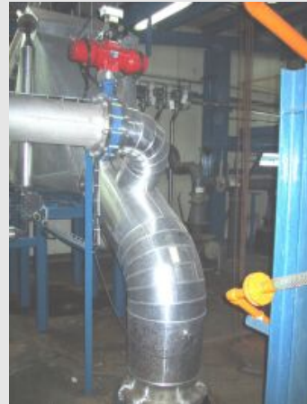
Entrée d'air ambiant
