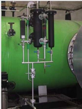
Niveaux de chaudière
