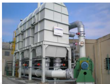
Instalación de oxidación térmica regenerativa en empresa de envases de aluminio extrusionado
