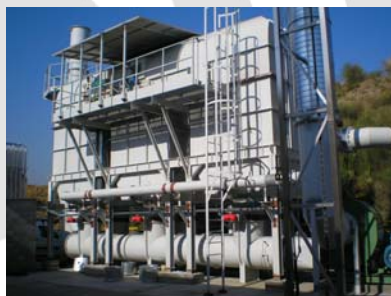
Instalación de oxidación térmica regenerativa en empresa de extrusión, laminación e impresión de films
