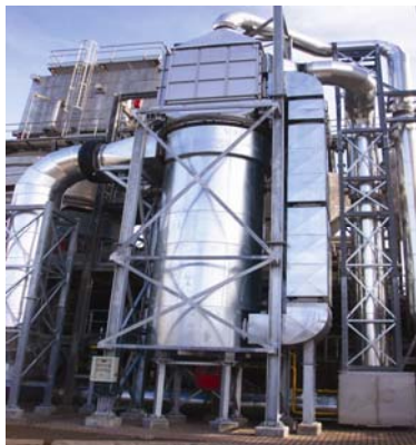
Calentador indirecto modular de aire con una potencia de 5 MW
