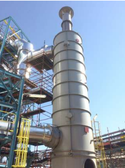
➔ Calentador de 8,5 MW instalado en una planta de ácido sulfúrico en Namibia.
